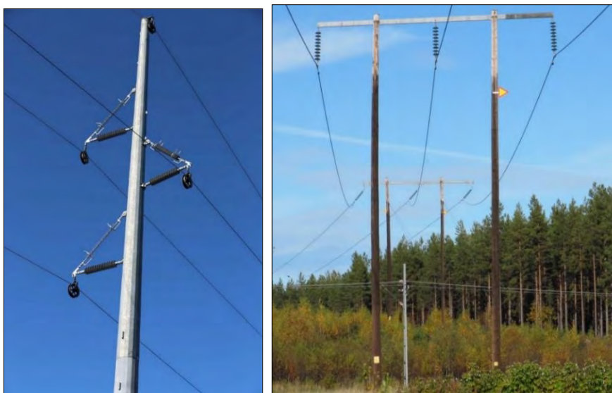
Figur 4. Exempel av planerad stolpkonstruktion. Exemplet till vänster visar gitterstolpe i vertikal stålårsstolpe och exemplet till höger visar portalstolpe i trä.
