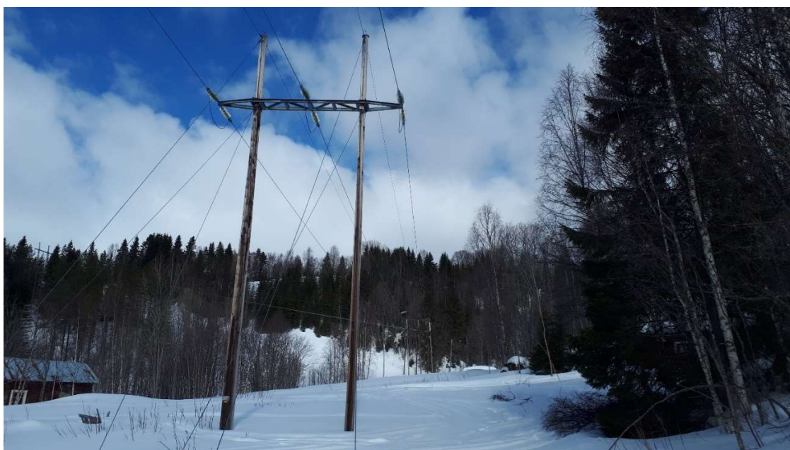
Bild 2. Visar avspänningsstolpen närmast före ställverket i Linnvasselv.
