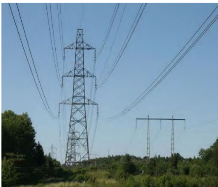
Figur 9. Exempel på julgransstolpe i stål (till vänster) bredvid en portalstolpe (till höger).
