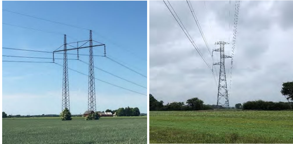
Figur 7. Exempel på ostagad portalstolpe (B-stolpe) med två upphängda topplinor till vänster och en kompaktstolpe till höger.
