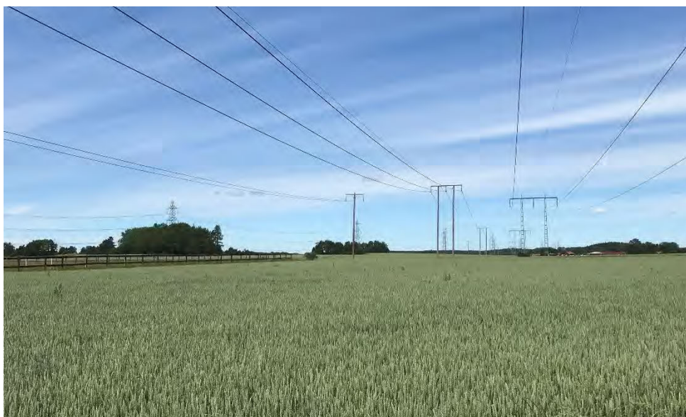
Figur 49. Befintliga ledningar vid Fjällsta gård, vy mot norr. Från vänster till höger syns Svenska kraftnåts sambyggda KL 42 S4 och CL6, Trafikverkets 2x66 kV, Vattenfalls 70 kV samt Svenska kraftnåts 220 kV KL42 S8 som ska rivas.
