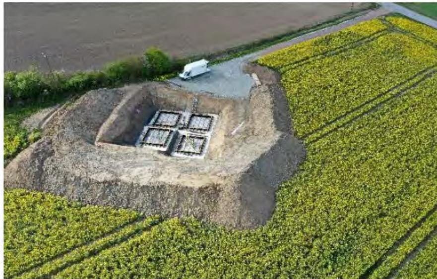
Figur 12. Fundamentgrop för en stubbe på jordbruksmark med tillhörande arbetsväg. Arbetsområdet kring stolpen återställs efter att stolpen är färdigbyggd.
