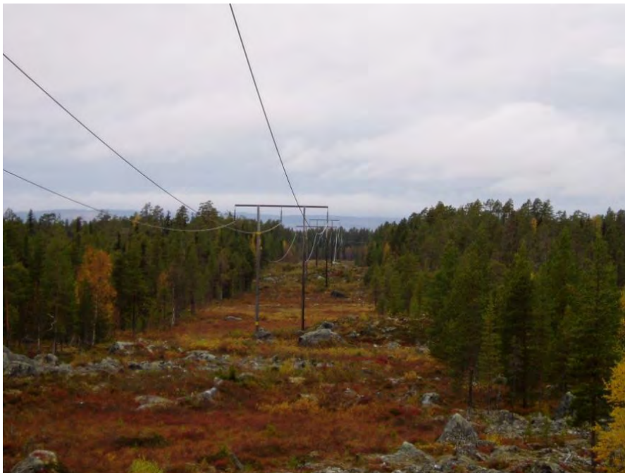
Figur 6. 130 kV luftledning i regionnätet, trädsäker.
