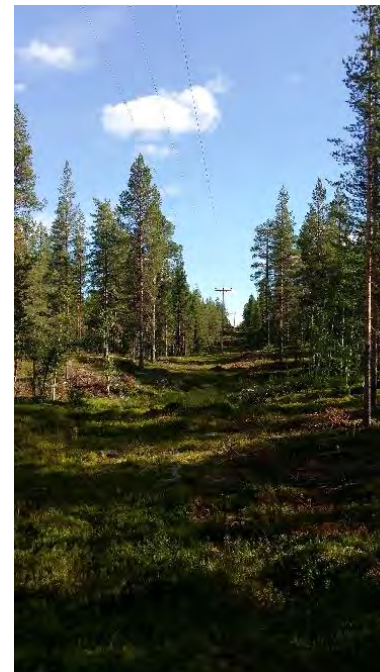
Figur 7. 20 kV luftledning i lokalnätet, ej trädsäker.
