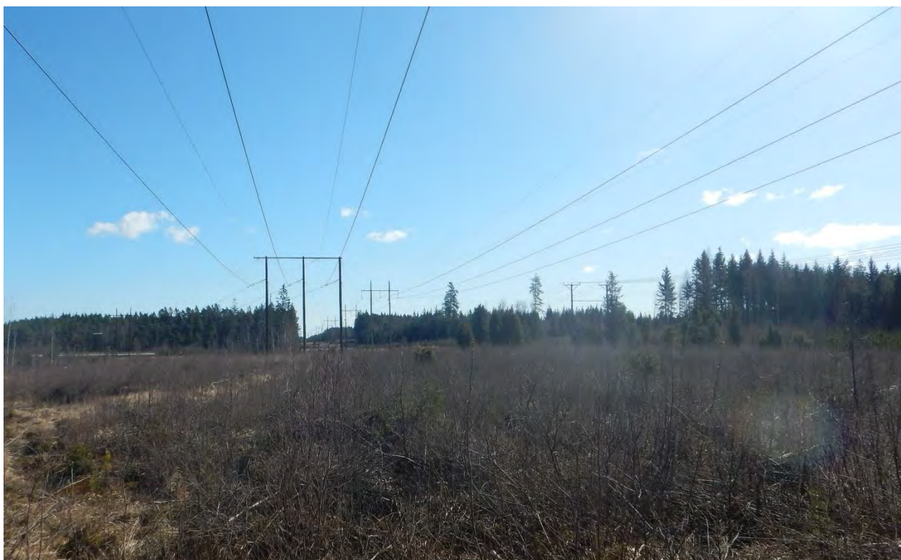
Figur 4. Befintliga ledningar sett från station Laggarhult och österut.
