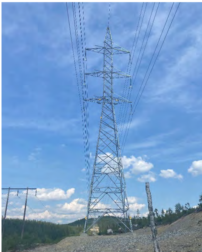
Figur 5 Stålstolpe på ledningen Tovåsen-vindpark Björnberget. Stolparna kommer bli 30-40 meter höga beroende på spännlängd och topografi. Observera att detta är en stolpe med duplex, (två ledare/linor per fas) medan aktuell ledning Alby-Tovåsen planeras med triplex (tre ledare/linor per fas).
