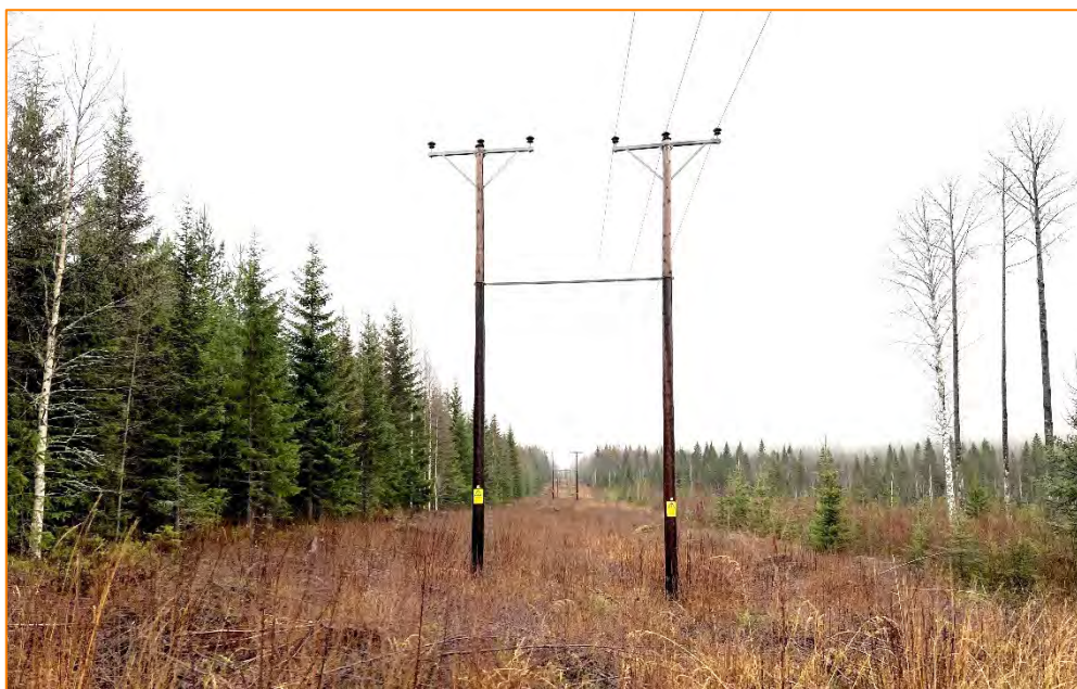
Figur 9 Befintliga 20 kV ledningar
