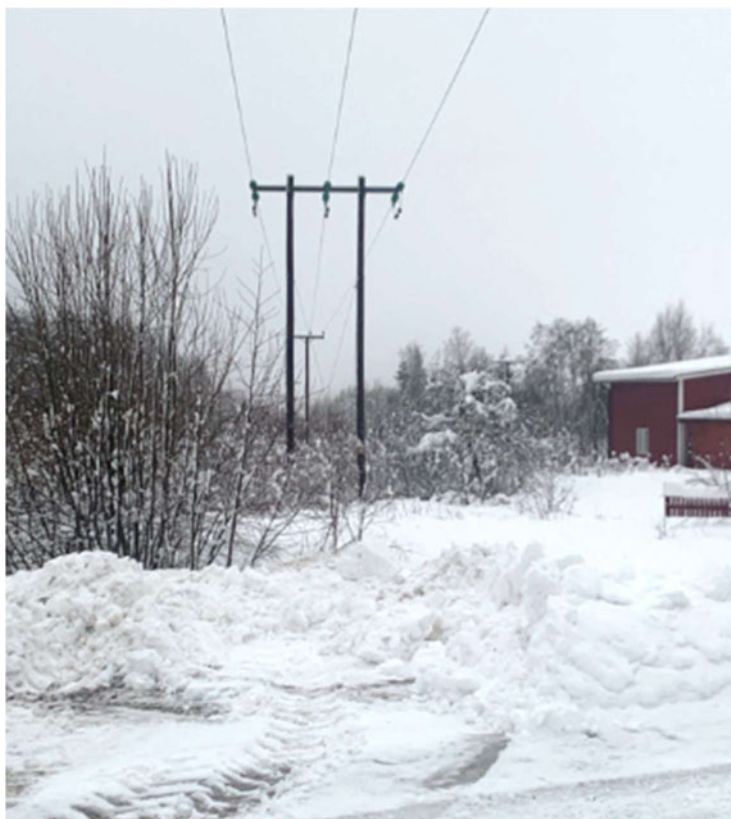
Figur 2. Exempel på portalstolpe tillhörande delen A11S1 av den aktuella ledningssträckningen.
