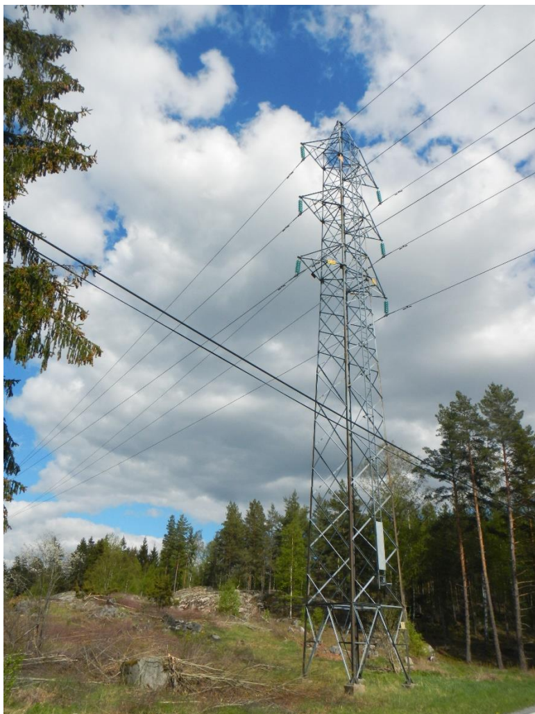
Figur 8. Befintlig ledning i enbent stål stolpe från Sigtuna – Tjusta.
