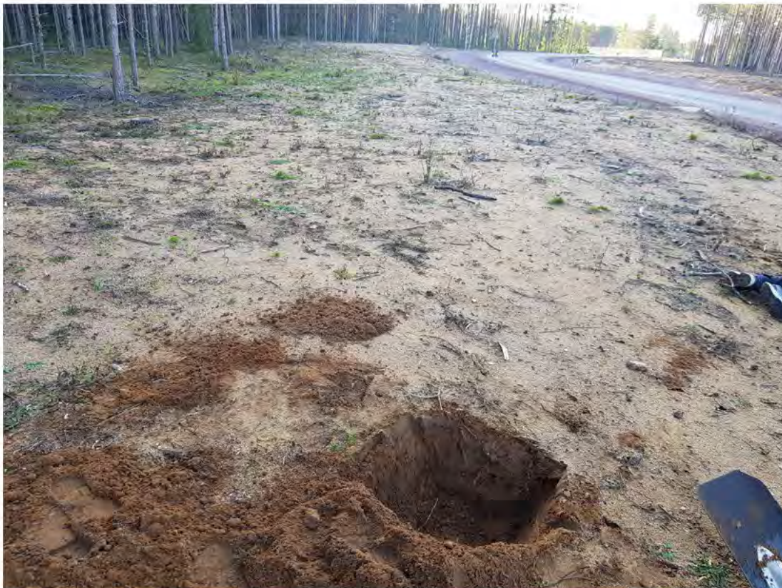
Figur 2. Vid Stackbo planeras markkabel parallellt med en nydragen väg, där vegetationsskiktet avbanats. Den okulära besiktning kompletterades med provgropsgrävning.
