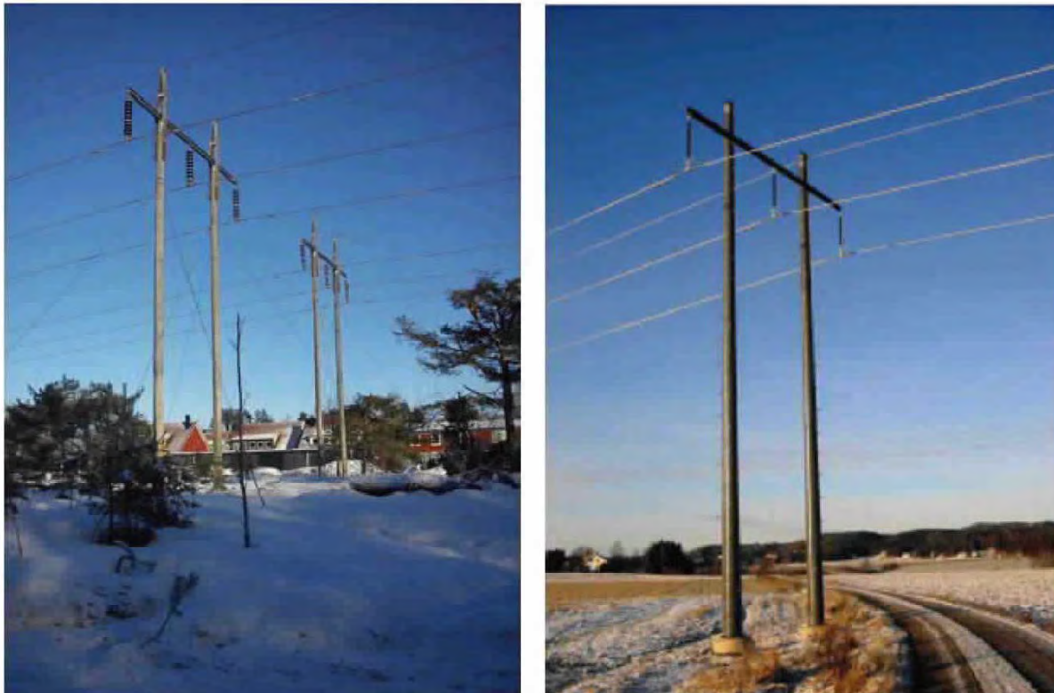
Figur 8 Vänstra bilden visar exempel på två parallella ledningar i portalstolpe. Den högra bilden visar exempel på en ledning med portalstolpar i kompositmaterial.
