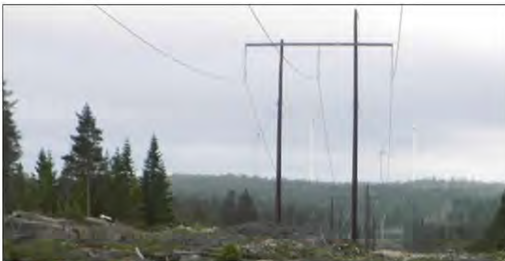
Figur 4–1. Exempel på 150 kV ledning med tvåbent portalstolpe och enkel topplina.
