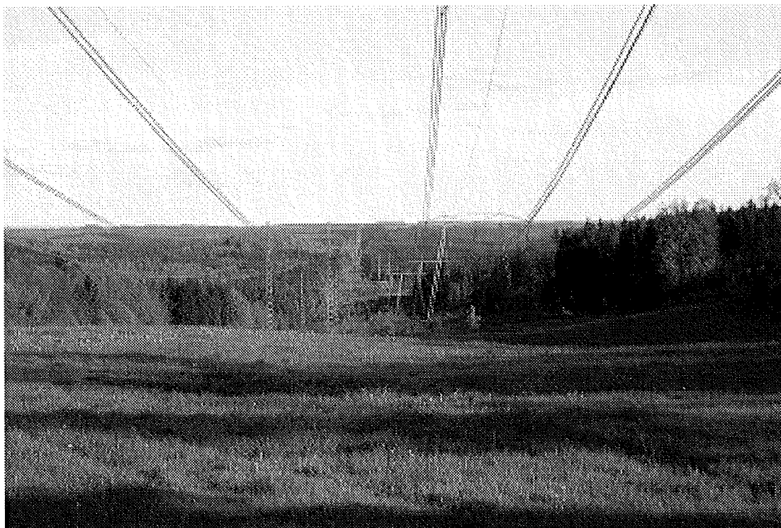
Fig.8 Vy över ledningsgatan genom skogsmark. 400 kV ledningen (FL14 S 3-4) vänster i bild, från Arvaskog och söderut över Nissans dalgång.
