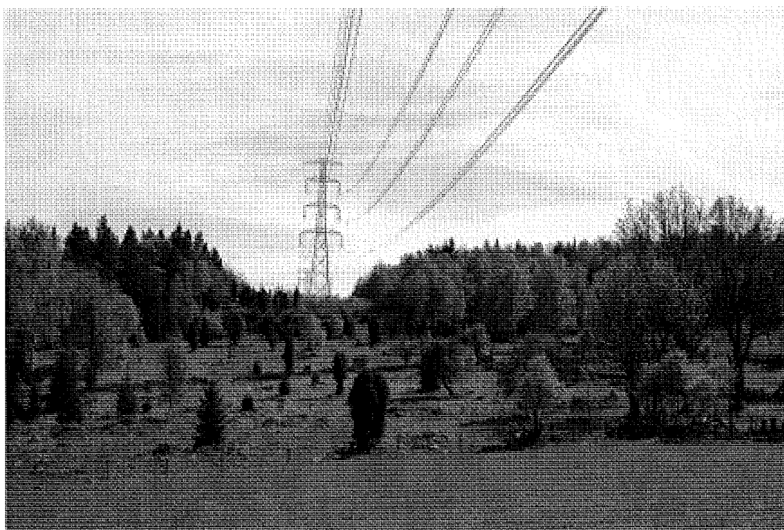
Fig. 5 Ledningen (FL12 s 3-4) sambyggd med 400 V ledningen (FL12 S 1-2) vid Gunnarsjö.
