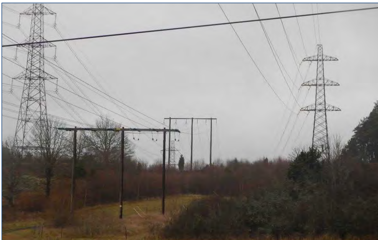
Figur 2. Foto över befintliga luftledningar på sträckan taget norrut. De ledningar som berörs av aktuellt samråd är uppförda i fackverksstolpar av stål (ledning L1 och L4), till höger i bild, samt i träportalstolpar (ledning L2 och L3), mitt i bild. Till vänster skymtas Svenska kraftnäts stamnätledning uppförda i högre fackverksstolpar, dessa berörs inte av planerade åtgärder.
