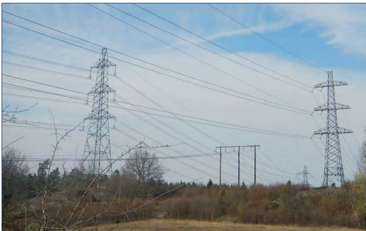
Figur 13. Foto över befintlig ledningsgata där skillnaden mellan stolptyper och stolphöjder tydligt framgår.
