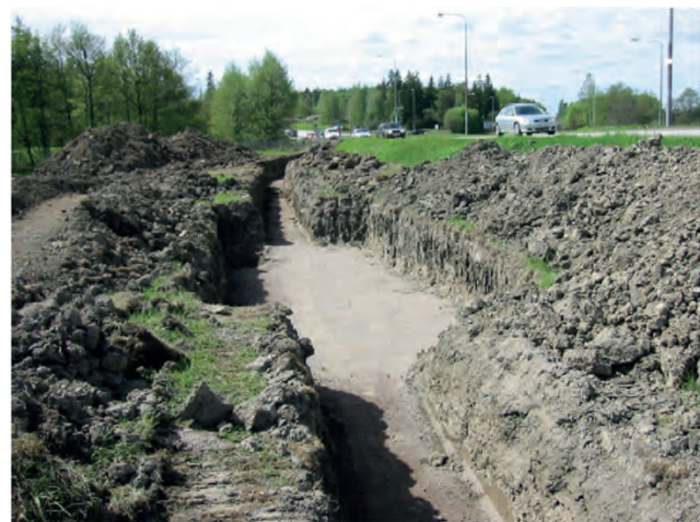
Figur 2.14 Skarvgrop för högspänningskablar.
