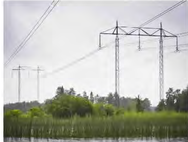
Figur 3. Bild över hur befintlig kraftledning och dess stolptyp kan se ut.
