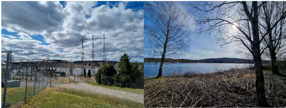
Figur 16. Hagfors ställverk och sjön Värmullen. I det vänstra fotot syns befintlig kraftledningsstolpe vid strandkanten och luftledningsspännet över sjön Värmullen skymtas. Foto: Rejlers Sverige AB.
